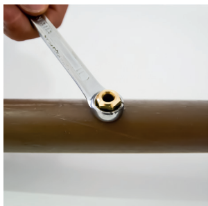
Figura 1: instalação do porta sensor
