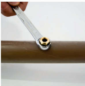
Figura 1: instalação do porta sensor
